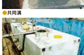
●耐震性貯水槽
