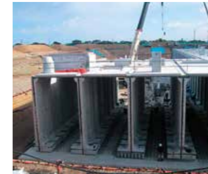
雨水地下貯留槽
