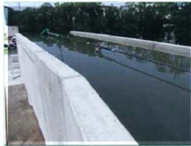
変位後の漏水なし
