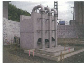
調整池のバルブピット
