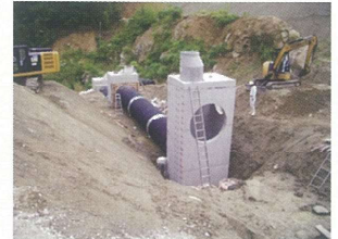
ハウエル管接続
