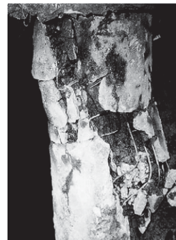
杭頭を剛接した杭の被害例
