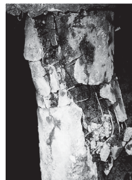
杭頭を剛接した杭の被害例
