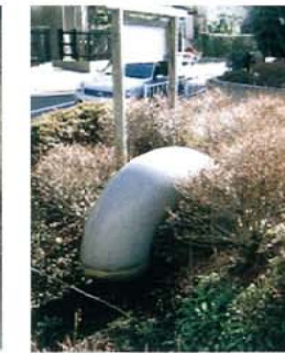
●地上部 換気孔
